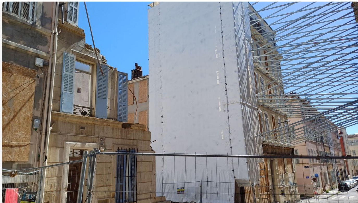
Un an après l'explosion et l'effondrement, la rue de Tivoli reste coupée devant le numéro 15 © Radio France - Emilie Briffod
