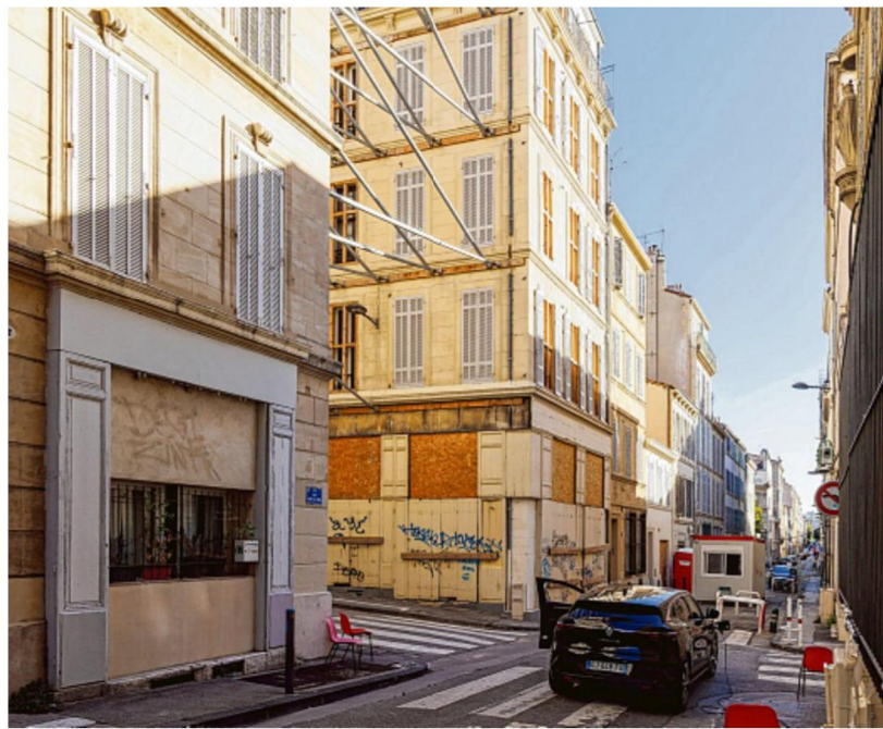
Toujours visibles, les états tiennent la façade du 19 rue de Tivoli et du 37 rue Abbé-de-l'Épée. Au total, six numéros dans ces deux rues restent inaccessibles aux anciens propriétaires et locataires. Dans des immeubles, des vols ont été rapportés après le passage de sociétés prestataires de la mairie.
